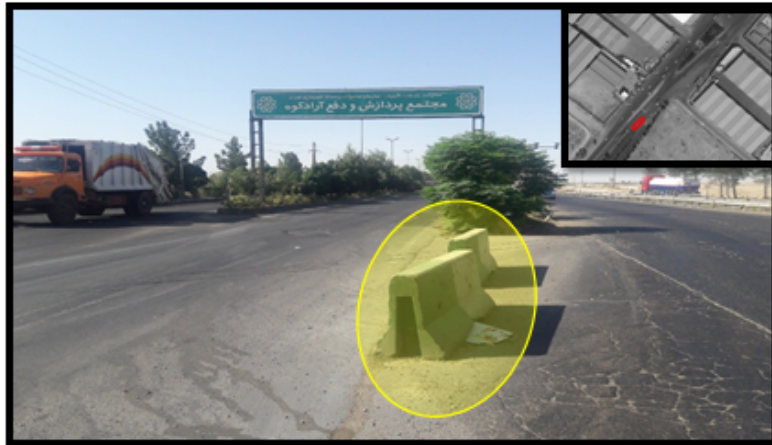
شکل ۴: وضعیت حفاظ بتنی جداکننده مسیر ورودی درب اصلی مجتمع پردازش آرادکوه و جاده قدیم تهران-قم
