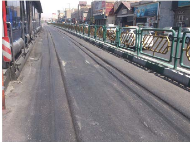
شکل ۱: خرابی rutting یا شیارشدگی در خط BRT
