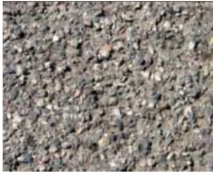
شکل ۳: شن زدگی ناشی از ضعف در اتصال قیر و سنگدانه
