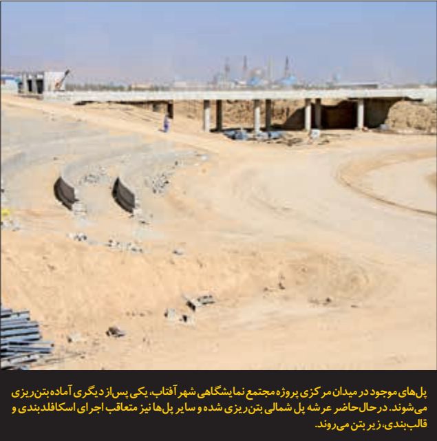
قطر میدان مرکزی مجتمع نمایشگاهی شهرافتاب به ۱۲۰ متر می‌رسد. اقدامات مربوط به تأسیسات میدان آب‌نما و نیز زیرسازی و تثبیت بستر در تمام بخش‌های این میدان به‌انمام رسیده و اقدامات مختلفی نظیر جدول کاری و تکمیل سکوها در دست انجام است.
