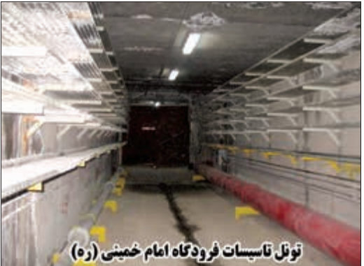
تونل تأسیسات فرودگاه امام خمینی (ره)
