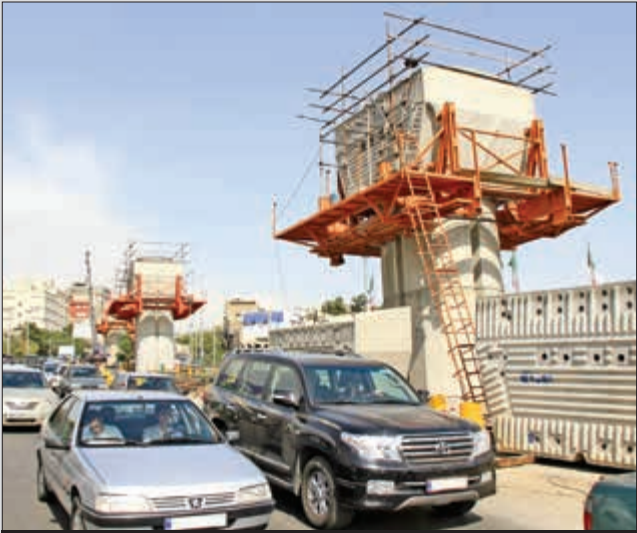
تاکنون ۷۸ درصد ستون‌های پل اصلی و ۶۹ درصد ستون‌های رمپ‌های دسترسی به‌طور کامل احداث شده‌اند. عملیات تولید و نصب سر ستون‌ها نیز در حال پیگیری است تا با تکمیل ستون‌ها و سر ستون‌ها، هیچ مانعی بر سر راه نصب قطعات بتنی عرشه پل اصلی باقی نماند.
