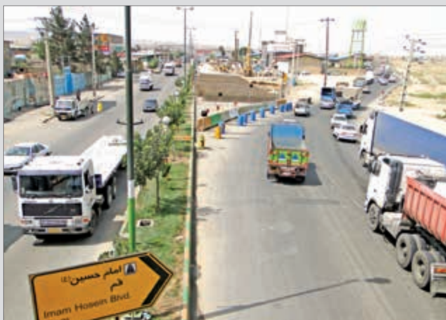
احداث پل های صندوقه ای بتنی، نیازمند عملیات اسکافلد بندی، قالب بندی و در نهایت بتن ریزی در جاست که این امر بدون ایجاد انحرافات ترافیکی میسر نیست.
