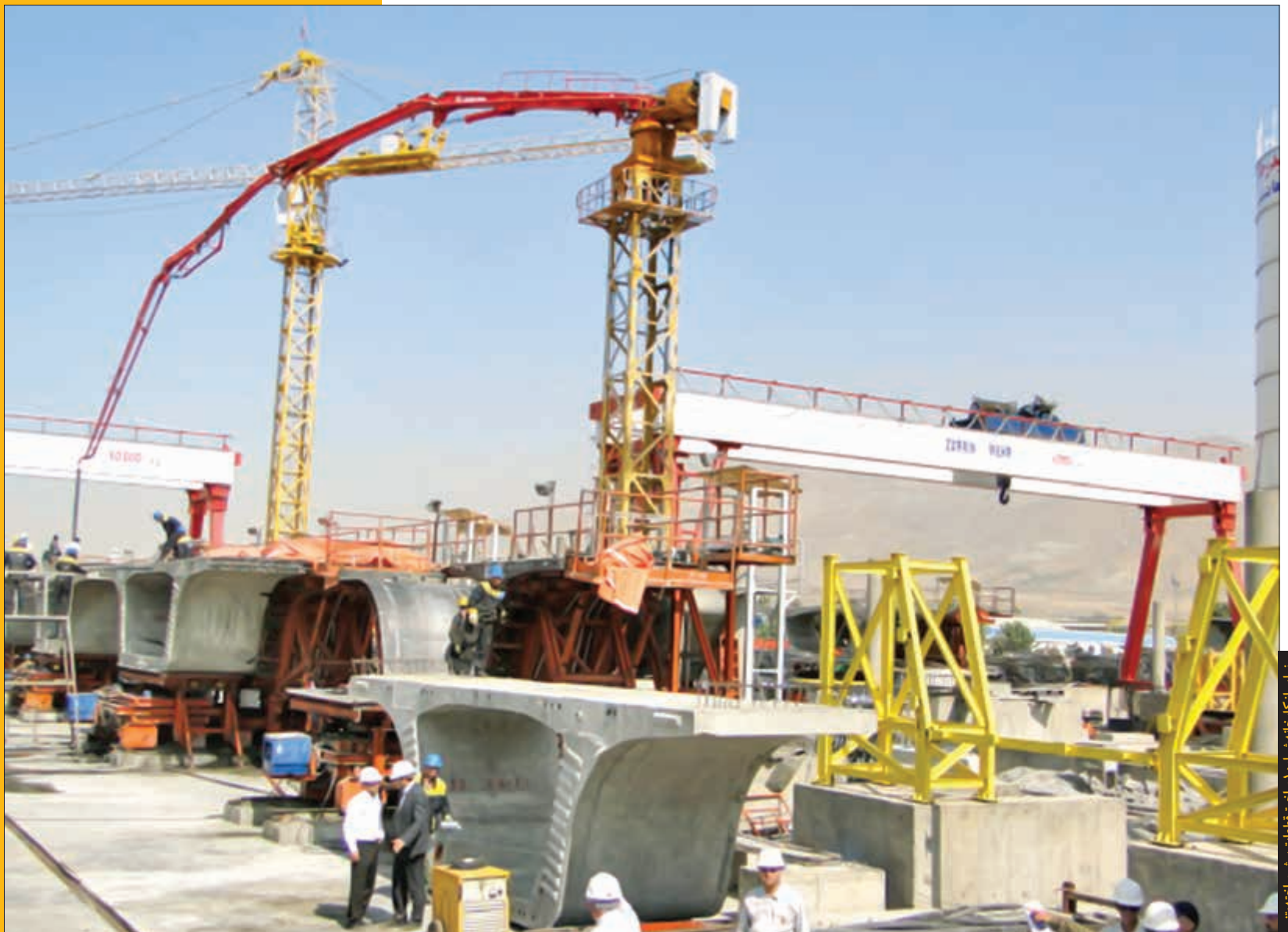
نمایی از کارخانه شماره ۱ ساخت قطعات پیش ساخته بتنی
