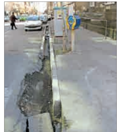
اجرای نامناسب جدول، سبب کنده شدن و سقوط آن به داخل نهر شده است. آدرس: تقاطع خیابان استاد نجات‌اللهی با خیابان شاداب
