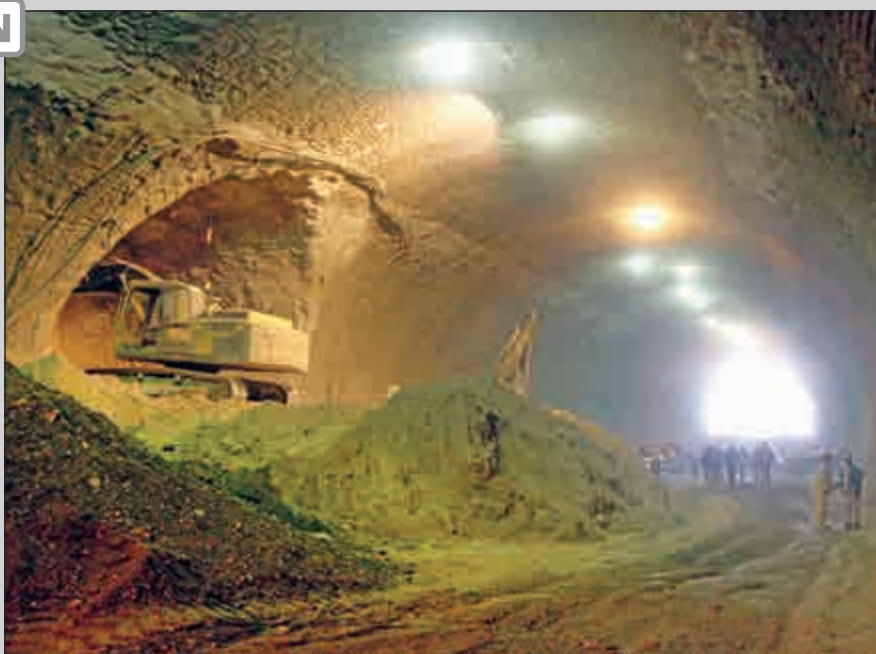
پروژه احداث تونل حکیم (پنجمین تونل ترافیکی شهر تهران) در محله عطارلی و تحکیم سیر می‌برد
