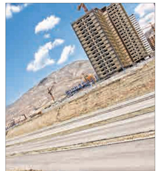
نمایی از پروژه ادامه بزرگراه شهید حکیم در ضلع غرب تقاطع بلوار ایران خودرو؛ بزرگراهی که باید حدود ۱۲ کیلومتر ادامه پیدا کند تا به تقاطع غیر همسطح کاروانسرا سنگی ۲ متصل شود.
