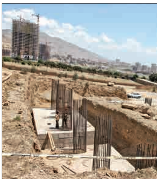
نمایی از عملیات احداث تقاطع غیر همسطح ادامه بزرگراه شهید حکیم با محور خادمین؛ تقاطعی که از یکسو امکان ارتباط بزرگراه شهید حکیم با محورهای مواصلاتی تهران - کرج را فراهم می‌کند و از سوی دیگر از طریق محور شریانی خادمین و تقاطع ۲۰ به بزرگراه شهید خرازی می‌پیوندد.
