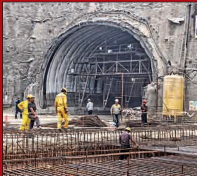
اجرای عملیات آرماتوربندی به عنوان یکی از اقدامات پیش نیاز اجرای بتن سازه ای کف، یکی از جبهه های فعال کاری پروژه است. در نتیجه این تلاش ها ۳۰ متر از کل بخش های پروژه زیر بتن سازه ای کف رفته است.
