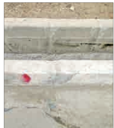
↑ خیابان سرنوشت شرقی، خیابان میرزا زاده، با وجود ارتفاع مناسب جدول، انتظار می‌رود عملیات کاتر زنی به طور صحیح پیش از اجرای تقویت بتنی صورت پذیرد.
