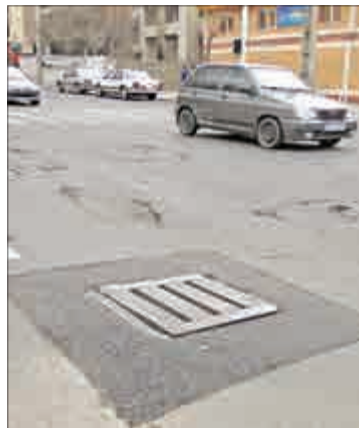
↑ خیابان ظفر قندی، نبش خیابان مظفری، اگرچه دست‌انداز حاصل از غیر همسطح بودن در پیچه به خوبی برطرف شده است اما سایر لکه‌ها و سطوح معیوب، مورد اجرای عملیات ساماندهی قرار نکرده‌اند.
