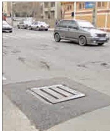
↑ خیابان ظفر قندی، نبش خیابان مظفری، اگرچه دست‌انداز حاصل از غیر همسطح بودن در پیچه به خوبی برطرف شده است اما سایر لکه‌ها و سطوح معیوب، مورد اجرای عملیات ساماندهی قرار نگرفته‌اند.
