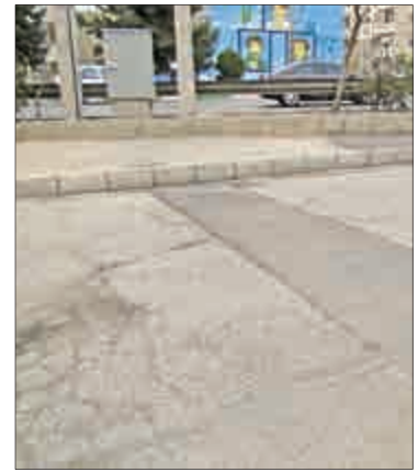
↑ خیابان فرجام غربی، انتهای خیابان باغدارنیا، هر چند نوار حفاری با کیفیت مناسبی لکه گیری شده است اما واحدهای اجرایی برای مرمت لکه ایجاد شده در فاصله یک متری این نوار نیز باید اقدام کنند.
