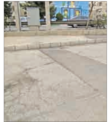
↑ خیابان فرجام غربی، انتهای خیابان باغدارنیا، هر چند نوار حفاری با کیفیت مناسبی لکه گیری شده است اما واحدهای اجرایی برای مرمت لکه ایجاد شده در فاصله یک متری این نوار نیز باید اقدام کنند.
